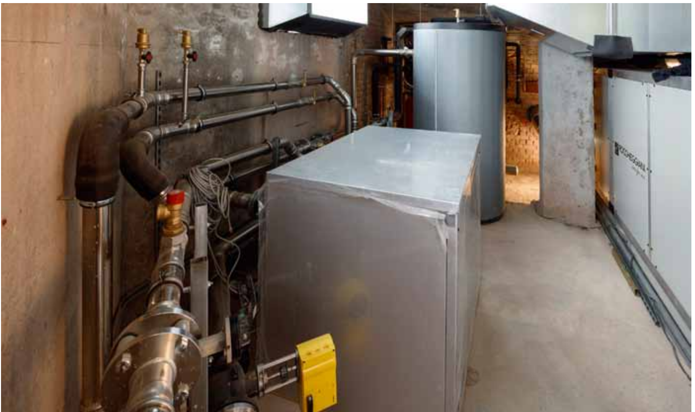
DE TECHNISCHE RUIMTE VAN DE BEMMELSE KERK TIJDENS DE RENOVATIE, MÉT NIEUWE ALPHA INNOTEC SWP WARMTEPOMP
